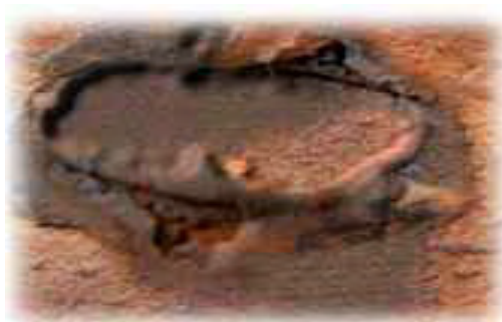
Типичное коррозионное повреждение
